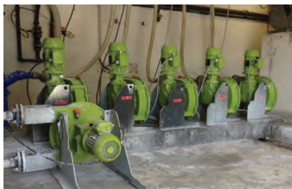
ALHX40 für Kalkmilch in der Abwasseraufbereitung
